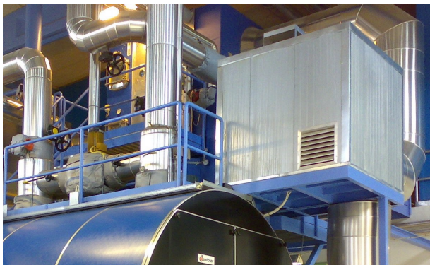
Foto fra Hvide Sande Varmeværk med Optinox® på en 10 MW kedel.
