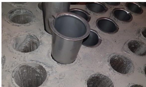
Foringsrør i konvektionspart
