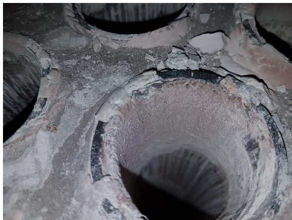
Foto visende belægninger i kedelrør
