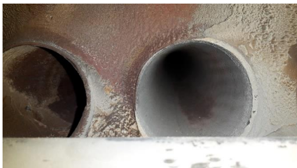
Foto visende tæring i vandret kedelrør
