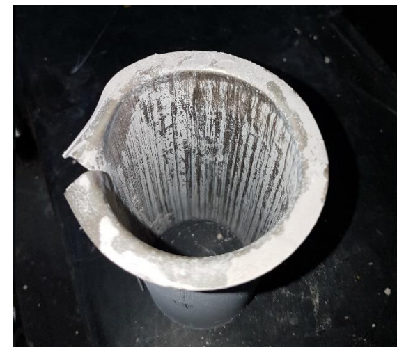
Foringsrør udført i AISI316L efter 1 års drift.
