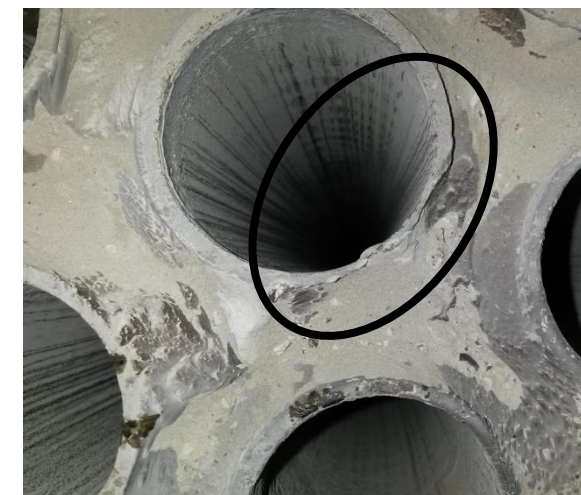
Foto visende tæring i lodret kedelrør
