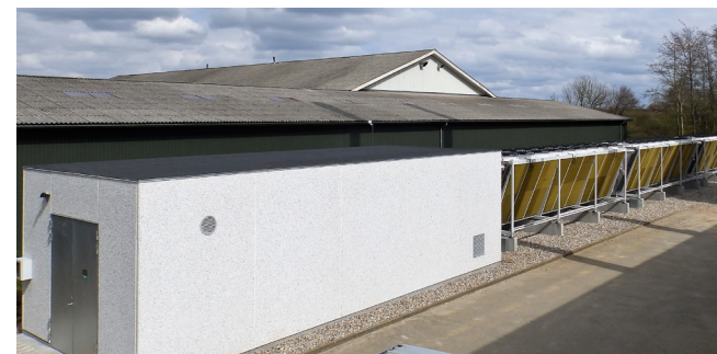
De tre energitagere er placeret bagved den nye bygning med elvarmepumpen.
