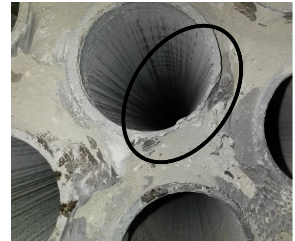
Foto visende tæring i lodret kedelrør
